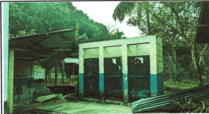
Foto 3: Techo y láminas de los baños desprendido y averiado por completo. Sustitución de pintura y reparación puertas de metal.
