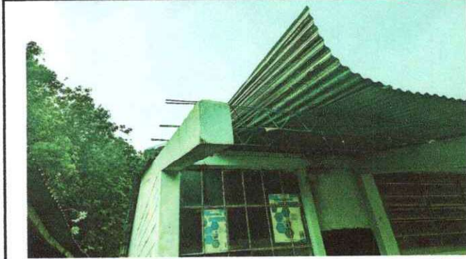
Foto 1: Techo afectado derivado de tormentas tropicales Eta y Iota, se desprendió por completo de las vigas.
