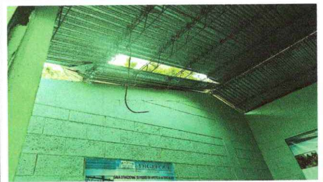
Foto 2: Debido a desprendimiento de techo con láminas, ingresa lluvia a las instalaciones.
