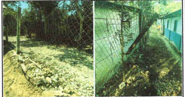
Foto 4: Malla del muro perimetral deteriorada, se requiere sustitución de malla y postes.
